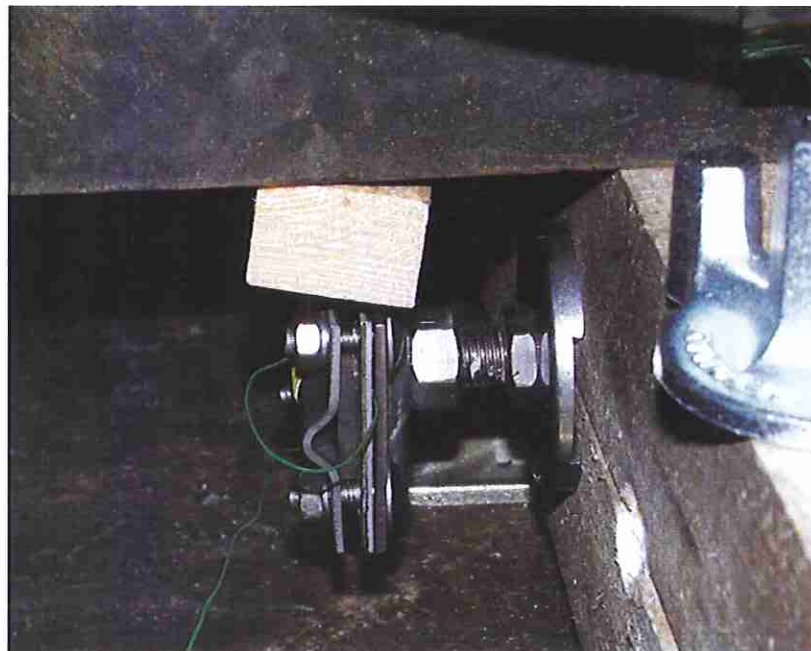
Bild 8: Untergeklemmtes Thermoelement im linken Anschluss (Kreuzklemme, Messung T1, Versuch 122-02/107)
