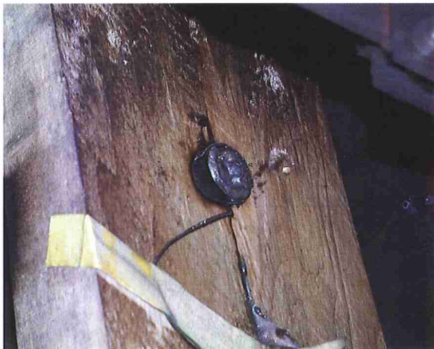
Bild 32: Rechtes abgeschmolzenes Ende der Durchführung
